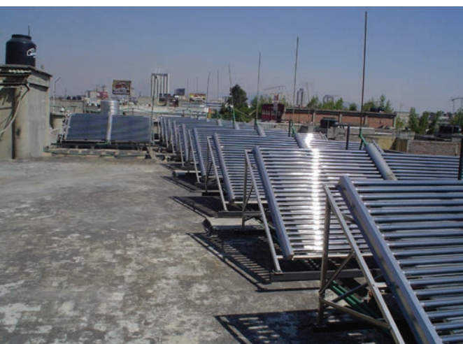
Paneles solares para calentar el agua para el baño de los internos.
